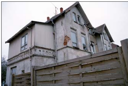
Verwittertes Gebäude mit teilweise abgebröckeltem Putz.
